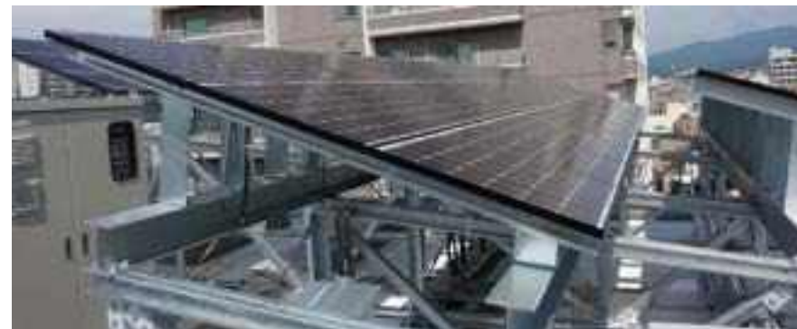
屋上設置太陽光パネル
