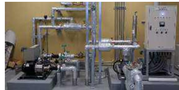
ろ過滅菌装置 (右) ・加圧給水ポンプ (左)
